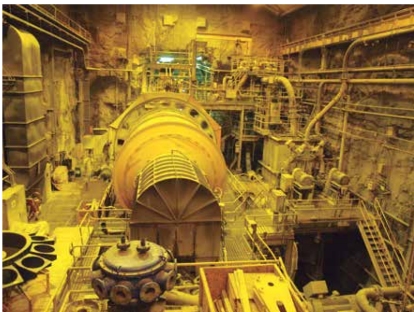
Maquinarias e infraestructura operan para mantener la línea productiva de la empresa, ocasionando desgastes por uso desmedido.
