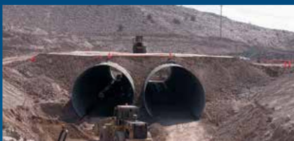
Alcantarillas de acero
