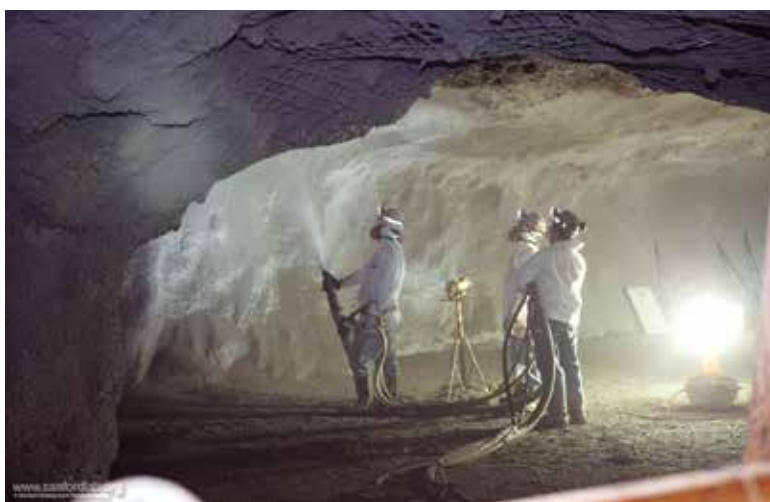
Para fortalecer la unión del macizo rocoso se aplica una inyección de concreto, mediante unidades de bombeo.
