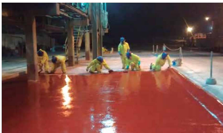
Patio de carga y descarga de ácido sulfúrico concentrado.
