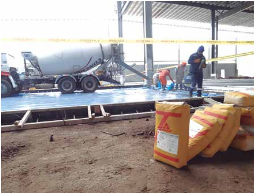
En talleres de maquinaria pesada es recomendable el uso de Sikafloor PurCem.
