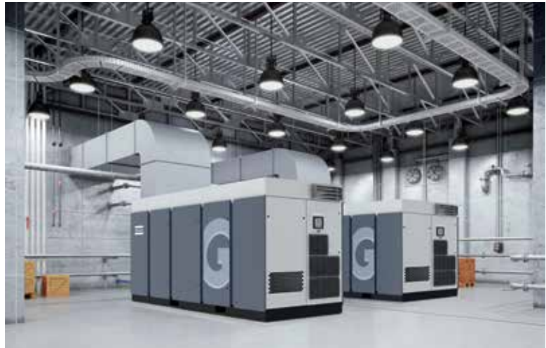
Sala de Compresores de Atlas Copco.
