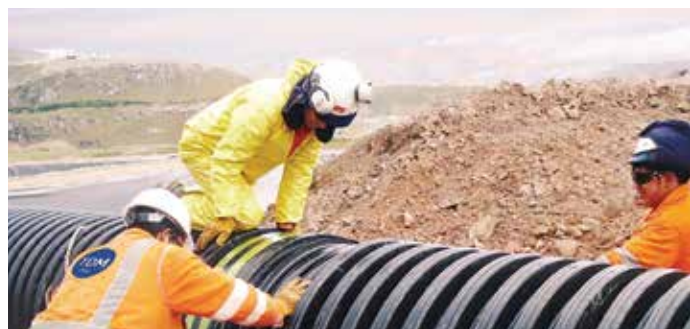
► Conducción de fluidos
