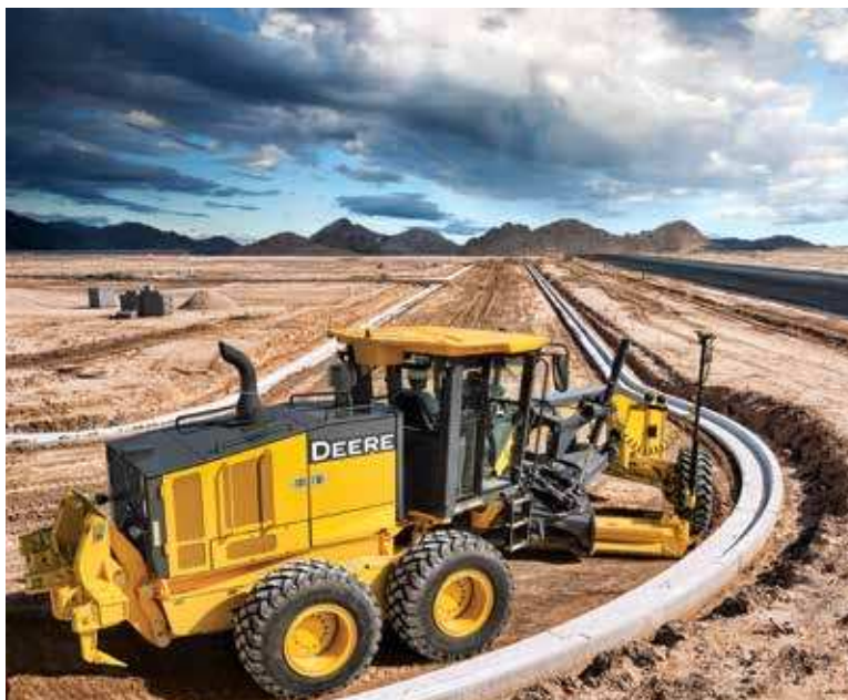
Este tipo de maquinaria pesada es empleada para la nivelación básica de suelos, ejecución de caminos, nivelación de terrenos agrícolas, construcción y limpieza de canales.
